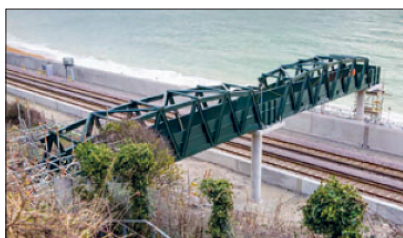
Рис. 4. Мост на железнодорожной линии Dover Sea Wall в графстве Кент, Великобритания («Strongwell Corporation») Fig. 4. Bridge on the Dover Sea Wall rail line in Kent, UK («Strongwell Corporation»)
