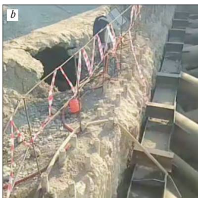
Рис. 2. Дефекты ограждений котлованов: а – течь с суффозионным выносом грунта; б – образование провалов грунта в зоне развития суффозионной течи
