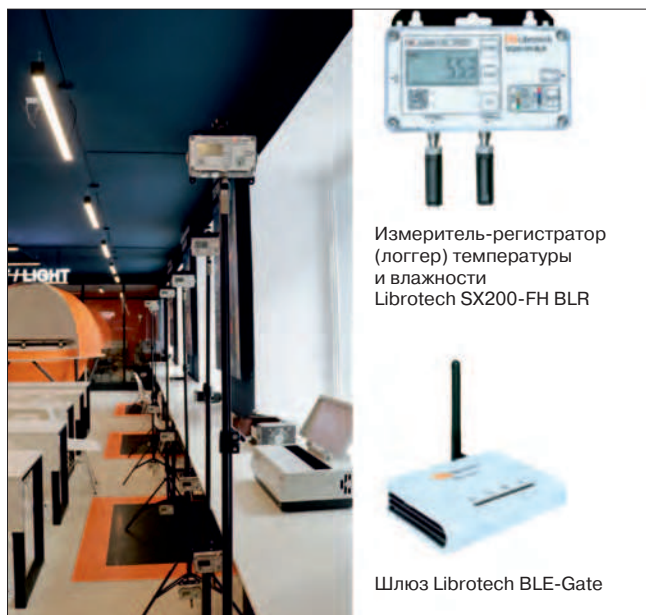
Рис. 3. Фотофиксация системы мониторинга микроклимата помещения
