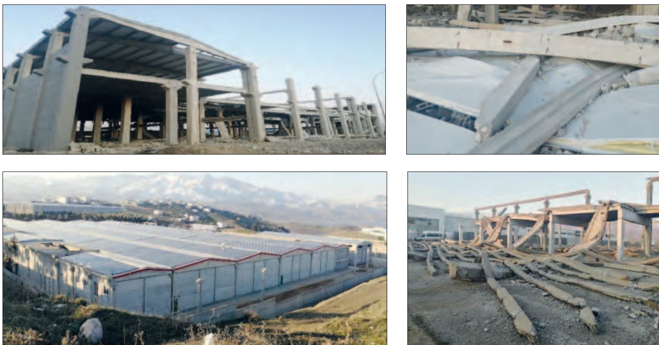
Рис. 21. Обзор поврежденных соединений сборного промышленного здания в Кахраманмараше Fig. 21. Overview of damages to the joints of a prefabricated industrial building in Kahramanmaraş
