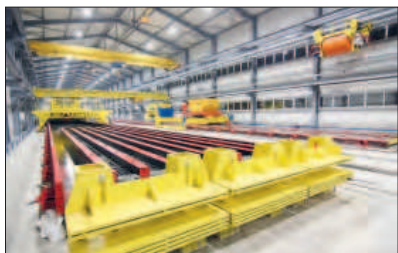
Рис. 1. Автоматизированный завод ЗАО «Рекон» с двумя универсальными станками, бетономесительным узлом, адресной подачей, раздатчиком-накопителем длиной 18 м. Мощность 100 тыс. м 2
