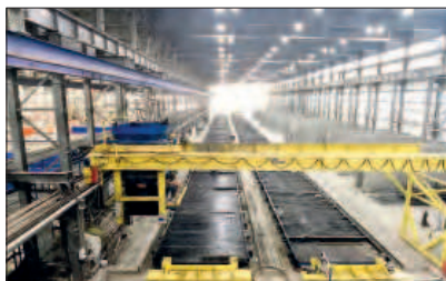
Рис. 2. Технологическая линия из двух универсальных станков 128×4 м с вибробетоноукладчиком с двойным перемешиванием бетона и выдачи шиберами с вертикальным и поперечным перемешиванием на два станка по выпуску изделий КПД и преднапряженных плит перекрытий длиной 8,2 м на ТОО «ДСК GLB» (Астана, 2022 г.)
