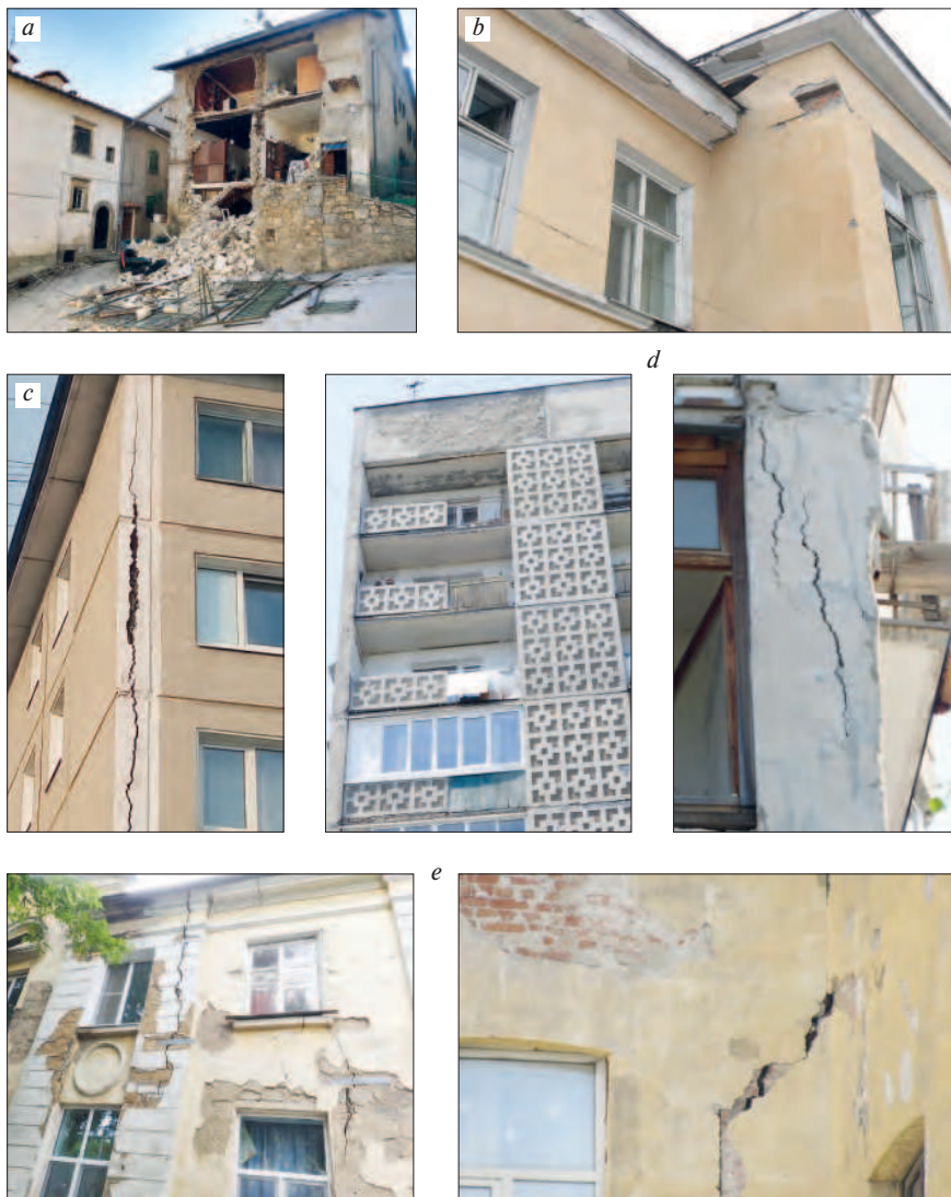
Рис. 2. Характерные повреждения при эксплуатации строительных объектов на сейсмически активных территориях (2008–2019 г.): а – обрушение фрагментов и конструкций малоэтажного жилого дома (г. Дербент, Республика Дагестан, годы постройки – 1935–1950); б – повреждения двухэтажного кирпичного здания школы (пос. Култук, Иркутская обл., год постройки – 1959); в, д – повреждения многоэтажных панельных домов из газозолотона (в – пятиэтажный типовой серии 1-335 КС, г. Ангарск, год постройки – 1972; д – девятиэтажный типовой серии И-163.02, г. Ангарск, год постройки – 1981); е – повреждения зданий исторической застройки (г. Ялта, Республика Крым). Источники фотографий: tvc.ru/news/show/id/161062 ; idei.club/61267-treschina-v-mnogokvartirnom-dome-54-foto.htm
