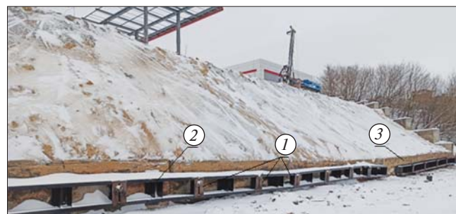
Рис. 3. Анкерное крепление деформированного откоса на оползневом склоне на абсолютной отм. 94.6: 1 – грунтовый анкер; 2 – анкерный обвязочный пояс; 3 – угловые монолитные железобетонные подпорные стены
