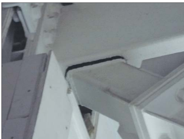
Рис. 1. Отрыв опорного раскоса фермы Fig. 1. Separation of the truss support brace
