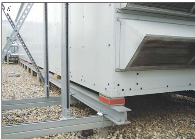
Рис. 2. Примеры реализованных решений по виброизоляции насосов (а) и оборудования систем отопления, вентиляции и кондиционирования (б)
