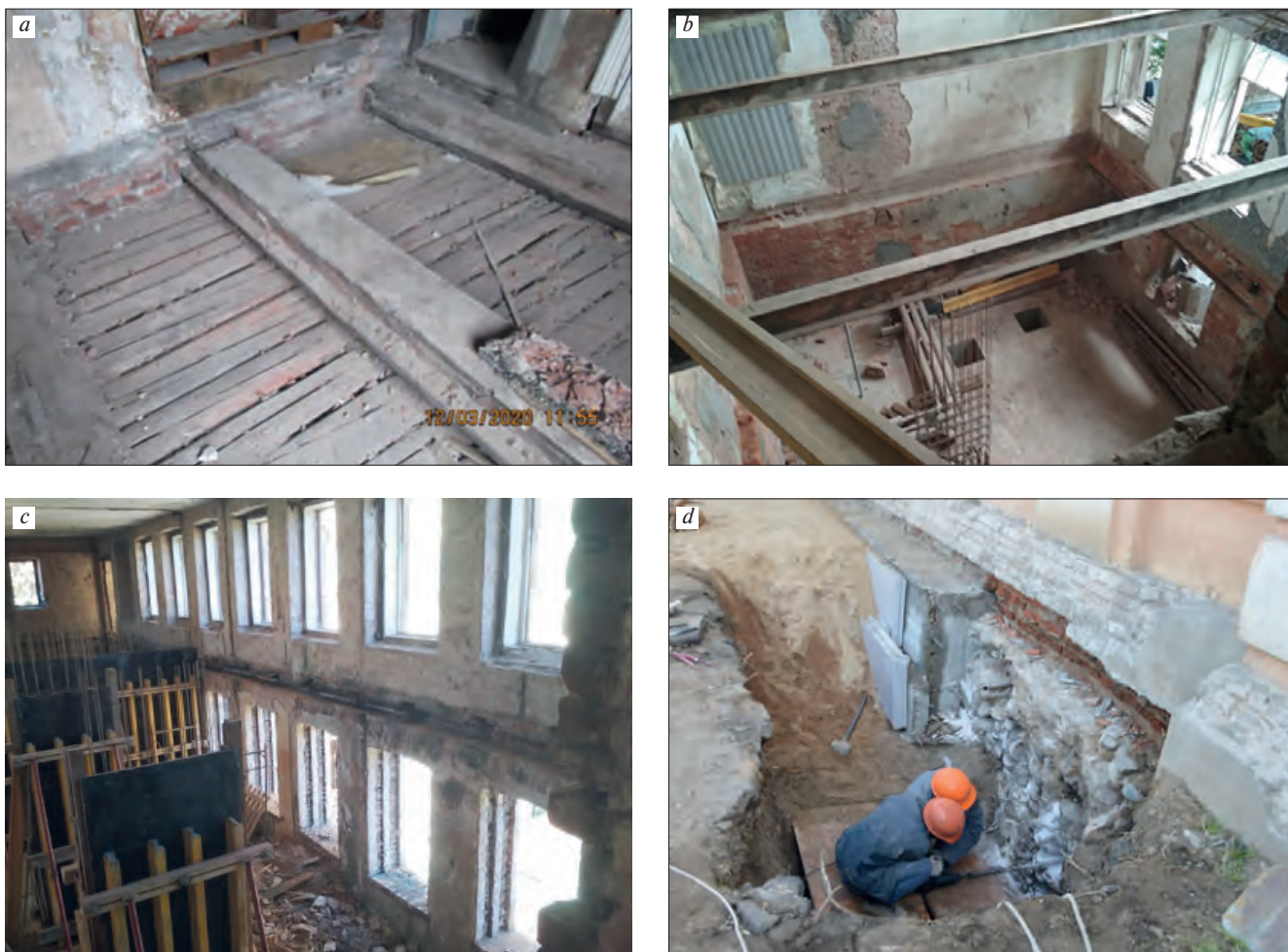
Рис. 3. Внутренние конструкции до реконструкции: а – лестничный настил; б – перекрытия; с – состояние внутренних стен; д – обследование фундамента
