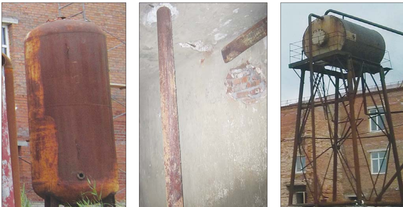
Рис. 7. Внешний вид корродированных металлических технологических емкостей и трубопроводов водогрязелечебницы Fig. 7. Appearance of corroded metal technological tanks and pipelines of the balneary
