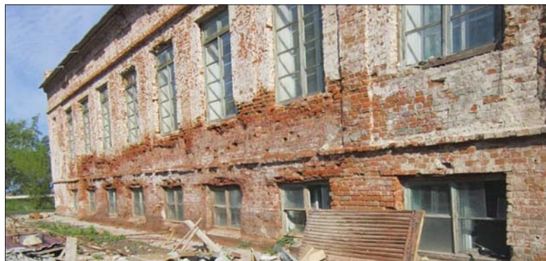
Рис. 2. Состояние фасада блока «Б» до проведения ремонтно-восстановительных работ
