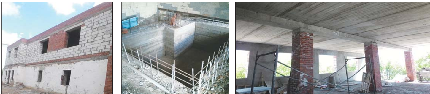
Рис. 9. Бетонирование накопительной емкости, восстановление наружной стены и новые железобетонные перекрытия в блоке «Д» Fig. 9. Concreting of the storage tank, restoration of the outer wall and new reinforced concrete floors in the «Д» block
