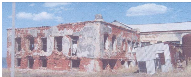
Рис. 3. Состояние фасада блока «Д» до проведения ремонтно-восстановительных работ
