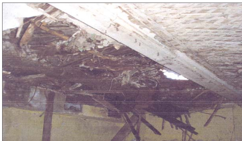
Рис. 4. Обрушение перекрытия цокольного этажа блока «В»
