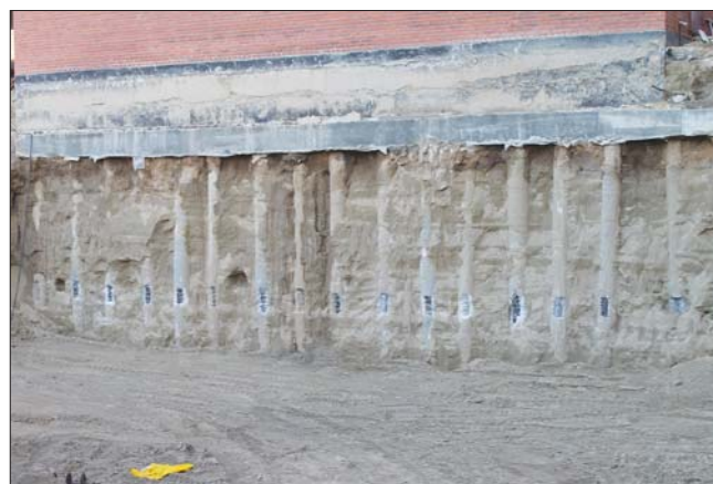
Рис. 2. Фрагмент общего вида возводимой ограждающей конструкции по оси 1–12 и примыкающего к ней строения
