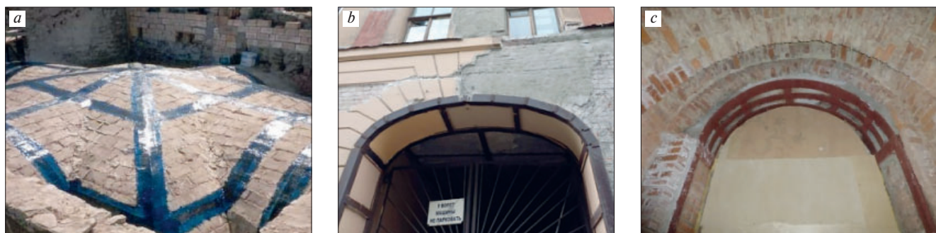
Рис. 1. Примеры нерационального усиления композитными материалами каменных сводов ( a ) и стальными элементами проездных арок ( b ) и оконных перемычек ( c )
