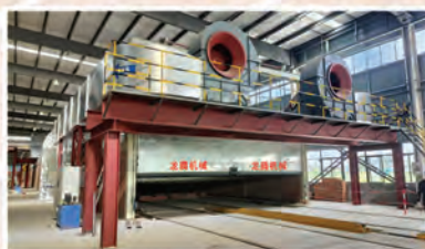
Туннельная печь D&S с внутренней шириной 9 м
