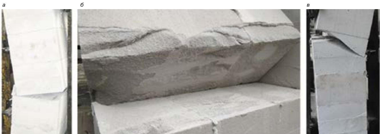
Рис. 2. Характер разрушения каменной кладки на полиуретановых швах по неперевязанному сечению: а, б – разрыв материала блоков вдоль полос полиуретановых швов; в – разрыв блоков по наклонной трещине
