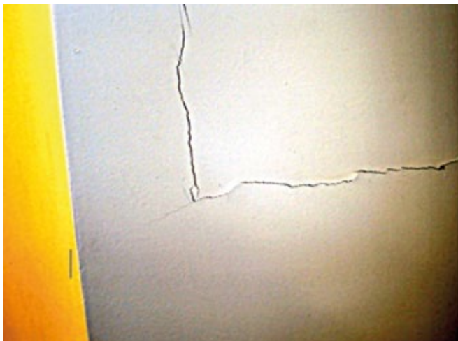
Рис. 1. Характерные дефекты в гипсокартонных конструкциях
