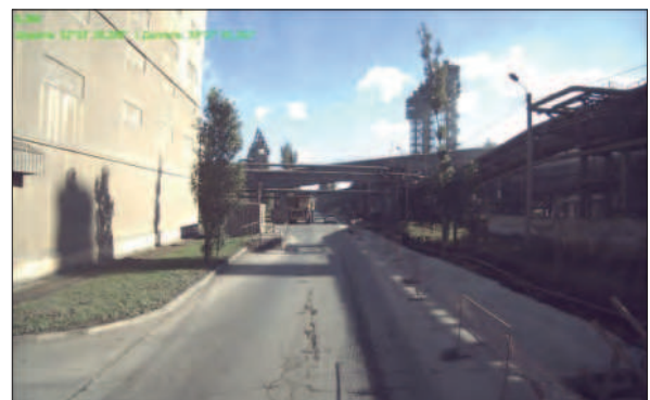
Рис. 4. Повреждения на поверхности асфальтобетонного покрытия Fig. 4. Damage on the surface of asphalt concrete pavement
