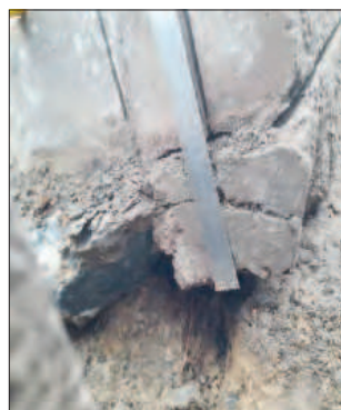
Рис. 3. Разрушение цементобетонного слоя дорожной одежды Fig. 3. Destruction of cement concrete layer of road pavement
