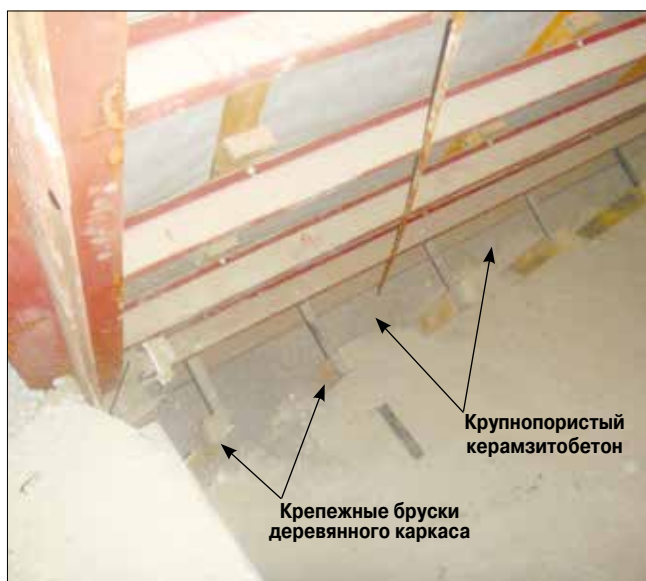
Рис. 8. Состояние чердачного пространства (над двухэтажной мансардой) Башкирского социально-экономического техникума после 20 лет эксплуатации
