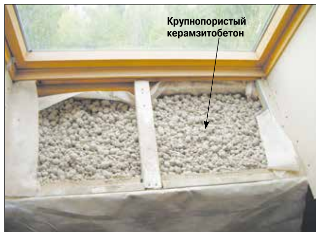
Рис. 6. Состояние отделочных покрытий (гипсокартона и деревянного каркаса) двухэтажной мансарды после 20 лет эксплуатации в неотапливаемых помещениях Fig. 6. The state of finishing coatings (plasterboard and wooden frame) of a two-story attic after 20 years of operation in unheated premises
