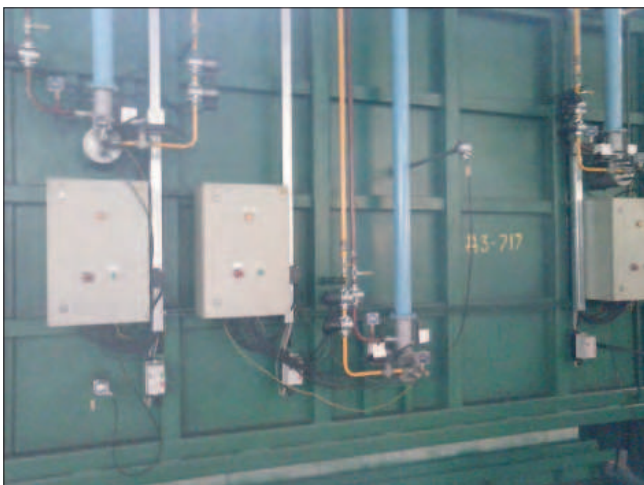
Рис. 5. Автоматические горелки печи Fig. 5. Automatic furnace burners
