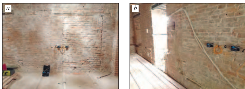
Рис. 5. Фотофиксация исследуемых заложённых проемов: a – проем № 1 (датчики измеряют колебания зоны шва); b – проем № 2 (датчики измеряют кладку заложённого проема)
