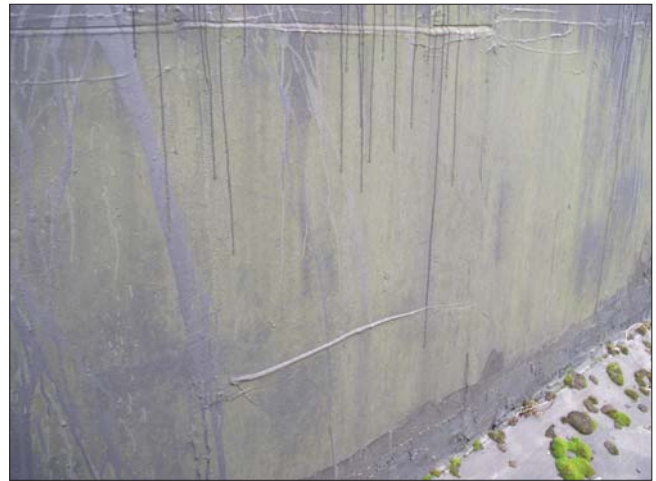
Рис. 5. Состояние боковых наклонных поверхностей складок покрытых мастикой Кровлелит до ремонта кровли после 37 лет эксплуатации. 2007 г.
