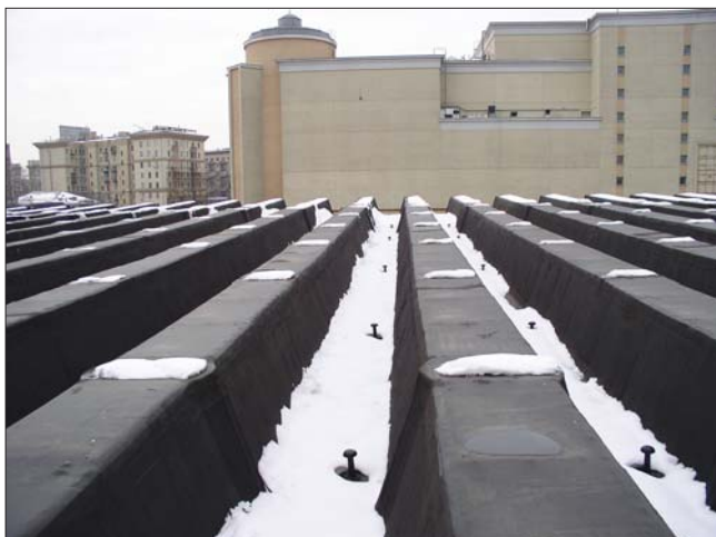
Рис. 8. Таяние снега вблизи кровельных аэраторов. Состояние после ремонта кровли весной 2010 г.
