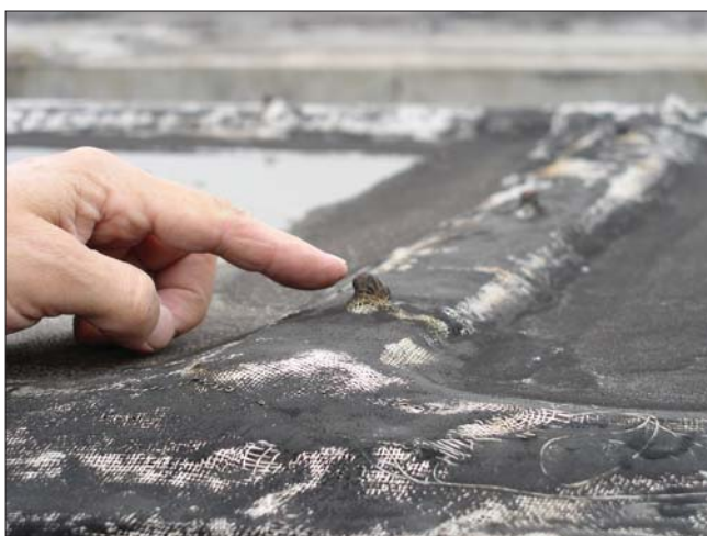
Рис. 4. Состояние мест сопряжений наклонных поверхностей с верхней частью складок до ремонта. 2007 г.
