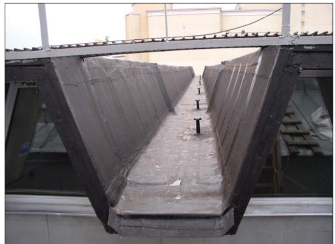
Рис. 6. Кровельные аэраторы 2010 г.
