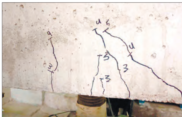
Рис. 15. Картина развития трещин в балке Б1 Fig. 15. Pattern of crack development in beam B1
