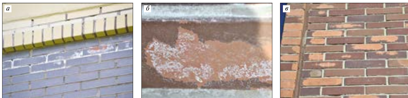
Рис. 1. Общий вид повреждений кирпичной кладки на фасаде здания: а – высолы с повреждением полимерного покрытия на кирпиче под молдингом; б – характерный вид шелушения полимерного покрытия; в – отслоения полимерного покрытия вследствие его отторжения кристаллизующимися солями
