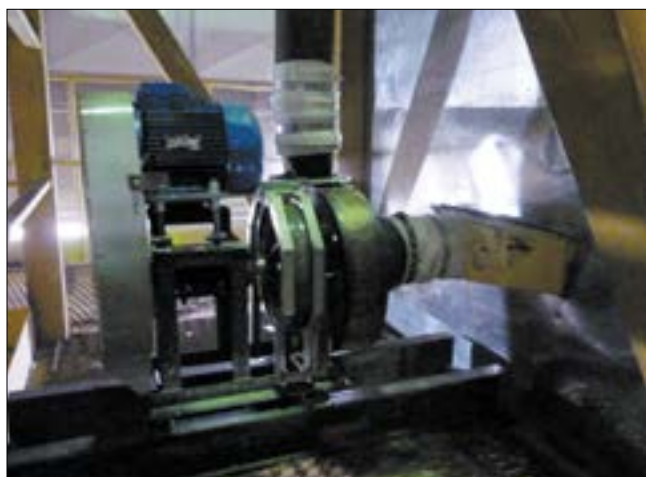
Рис. 4. Установка жарового вентилятора «Гелиотис» на печи
