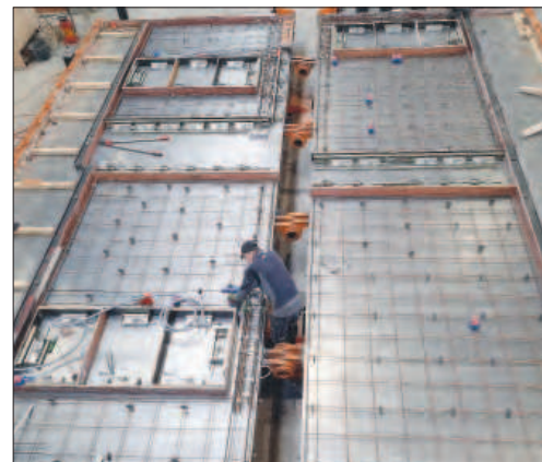
Опалубка «Бабочка» в развернутом положении – горизонтальная подготовка "Butterfly" formwork in the unfolded position – horizontal preparation
