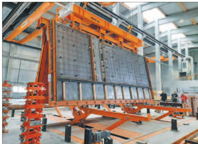
Плавное складывание опалубки с помощью специального гидравлического оборудования Smooth folding of the formwork using special hydraulic equipment
