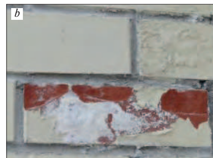
Рис. 3. Общий вид разрушающегося полимерного покрытия на кирпичной кладке ( a ); отслоение полимерного покрытия на поверхности кирпича вследствие высолообразования ( b ) Fig. 3. General view of the destructive polymer coating on brickwork ( a ); delamination of the polymer coating on the brick surface due to efflorescence ( b )
