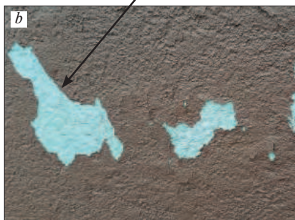
Рис. 2. Отслоение акриловой краски с поверхности штукатурного покрытия в комплексе «Европа» ( a ); фрагмент отслаивающейся краски ( b ) Fig. 2. Peeling of acrylic paint from the surface of the plaster coating in the Europe complex ( a ); a fragment of peeling paint ( b )
