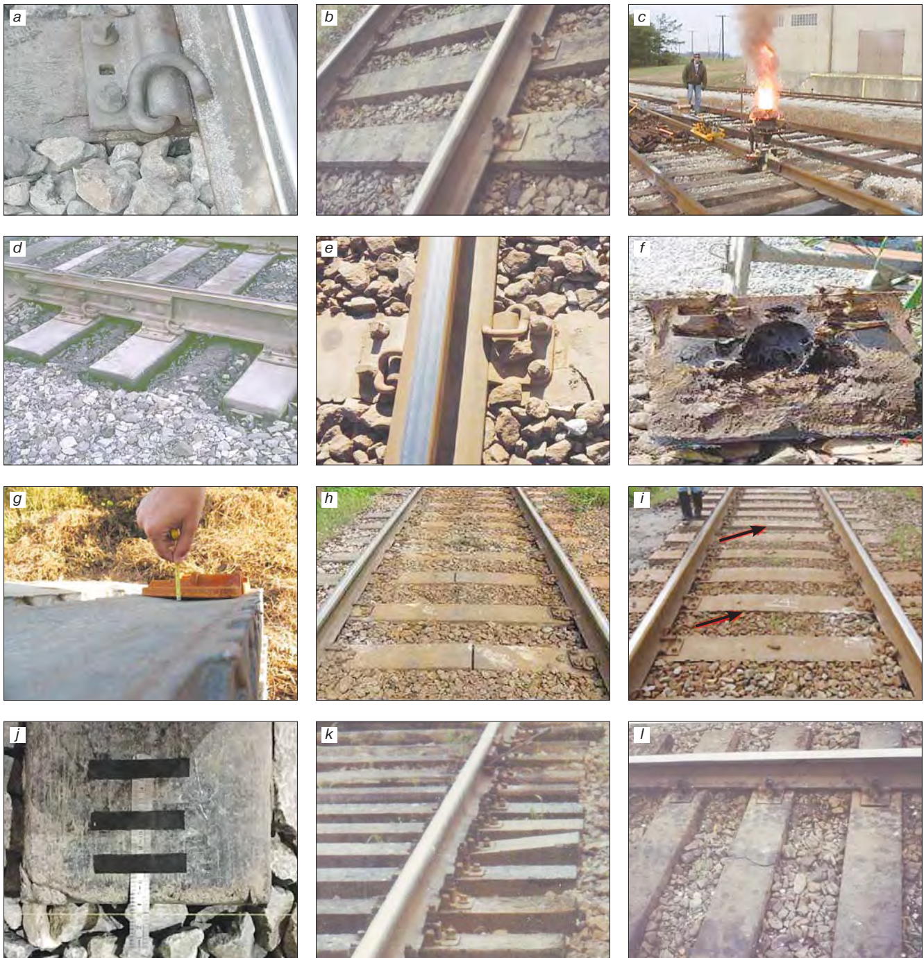
Рис. 20. Типичные дефекты композиционных подрельсовых оснований: a – трещины в зоне прикрепителя [115]; b – развитие сетки трещин на поверхности шпалы, вызванное нарушениями технологии изготовления [83]; c – опасность деструкции конструкции при термитной сварке рельса [115]; d – низкая стойкость к воздействию окружающей среды при технологических нарушениях производства [115]; e – развитая трещина в зоне системы крепления [116]; f – технологические пустоты в области скреплений [116]; g – неплоскость поверхности вследствие технологических нарушений при производстве [116]; h – излом в центральной части шпалы вследствие эксплуатационных нарушений [116]; i – выгиб центральной части шпалы в области загрязненного балласта [116]; j – повышенное продольное температурное расширение (изменение ширины колеи) при большом перепаде температуры [117]; k – излом шпалы под рельсом вследствие дефекта в виде сучка в нижнем армирующем деревянном брусе [83]; l – трещинообразование в верхней части шпалы вследствие дефекта в виде сучка в верхнем армирующем деревянном брусе [83]
